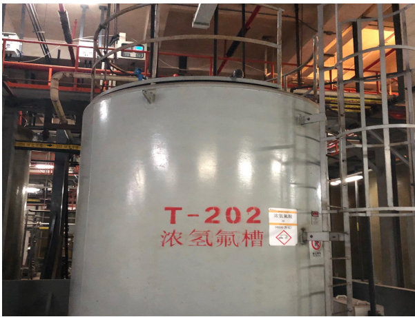
含氟废水处理系统
