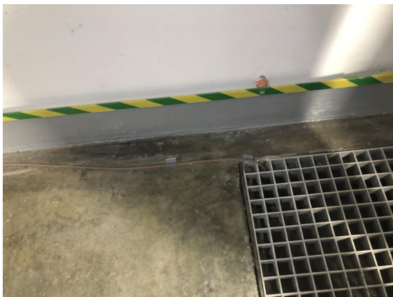
危废暂存间内截留沟和报警感应装置
