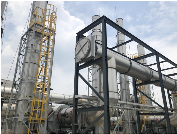
酸性废气排气筒
