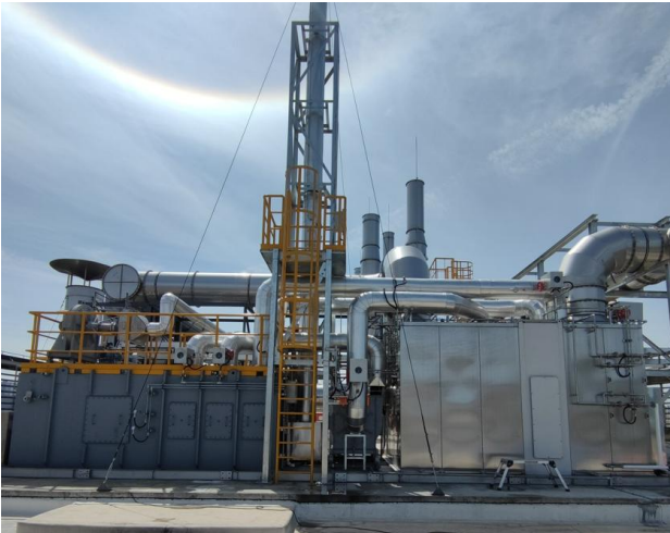
有机废气处理系统
