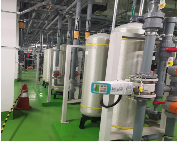
电镀废水处理系统
