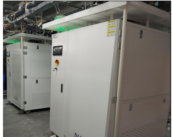
本地废气处理设施（等离子切割 POU）
