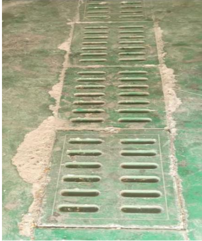
危废间整改前破损情况
